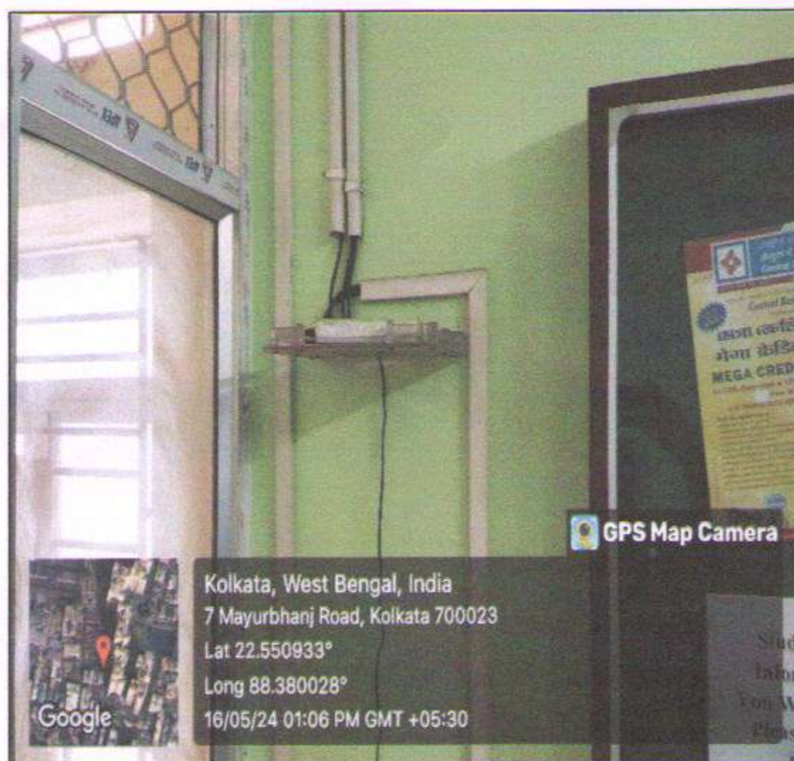
Wi Fi Router
